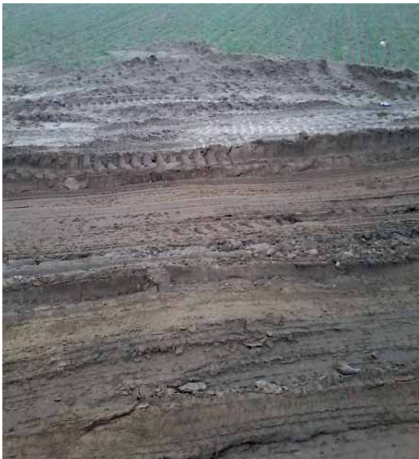
Fot. 1. Degradacja fizyczna polegająca na skrajnym i głębokim zagęszczeniu i odkształceniach plastycznych spowodowana wielokrotnymi przejazdami ciężkimi maszynami podczas modernizacji napowietrznej linii elektroenergetycznej w warunkach nadmiernego uwilgotnienia późną jesienią 2015 r. – linia 110 kV Pakość – Żnin Fot. M. Heinrich
